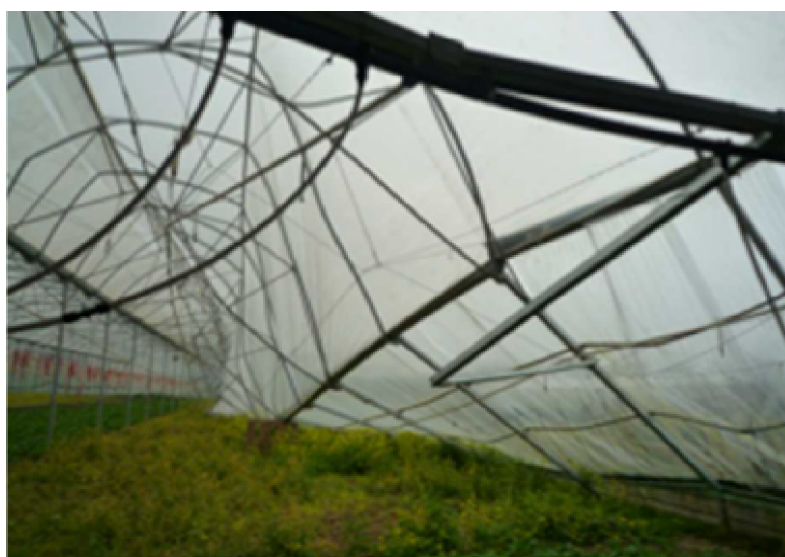
b) Danos devido ao vento (MARTINS, 2014)
