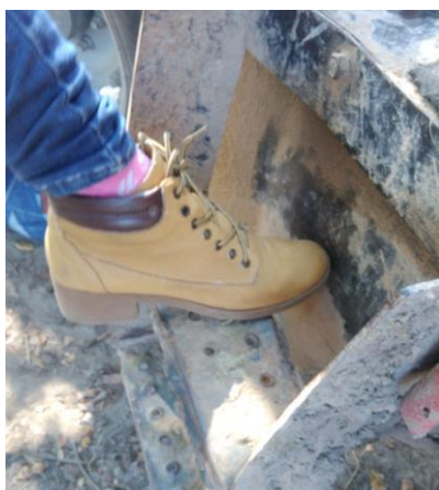
Foto 2. Condições dos degraus de acesso à máquina.
