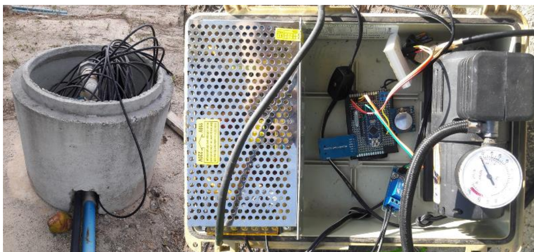
Figura 4. Instalação do sistema no poço profundo localizado na Universidade Federal do Ceará.
