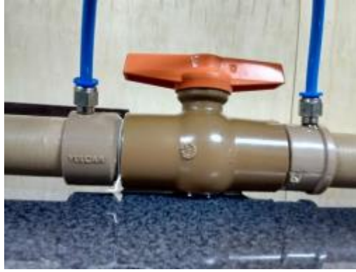
FIGURA 2 – Tomada de pressão nos adaptadores
