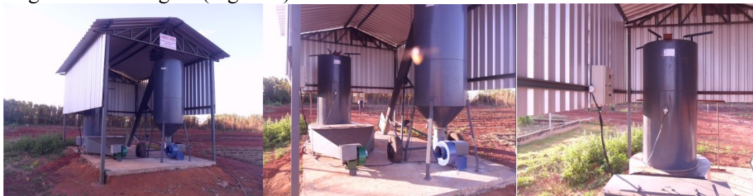
FIGURA 1. Unidade de secagem e armazenamento de grãos.
