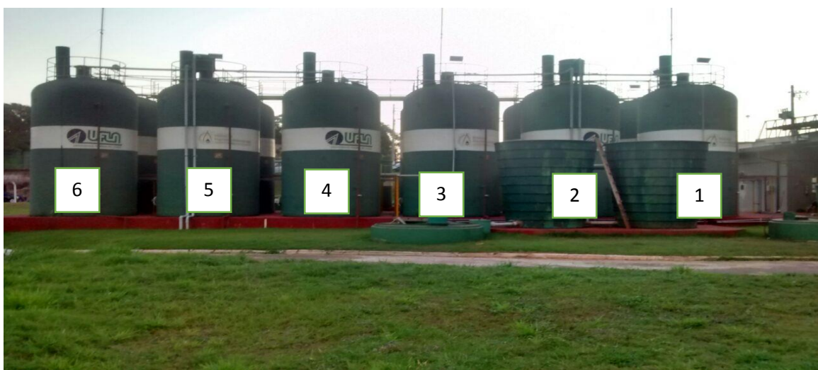
Imagem 1: Vista panorâmica dos reatores Upflow Anaerobic Sludge Blanket – UASB.
