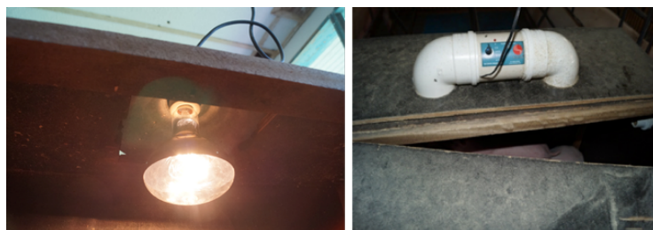
Figura 1 – Sistemas de aquecimento. LIV e TAE. instalados nos
