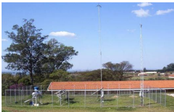
FIGURA 1. Vista panorâmica do NEAR e da instalação do sistema híbrido eólico fotovoltaico. Panoramic view do near and installation of photovoltaic hybrid wind system
