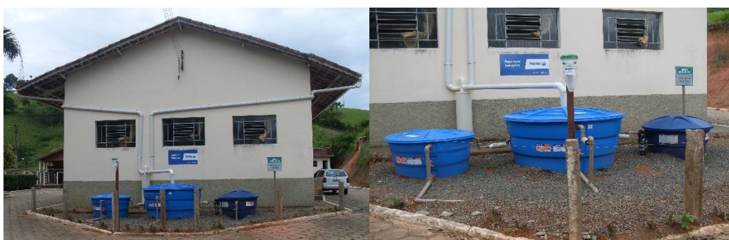
Figura 2 - Estrutura para captação e armazenamento de água de chuva
